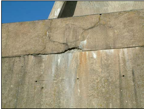
185. Fissures et saletés dans la paroi extérieure en béton.
