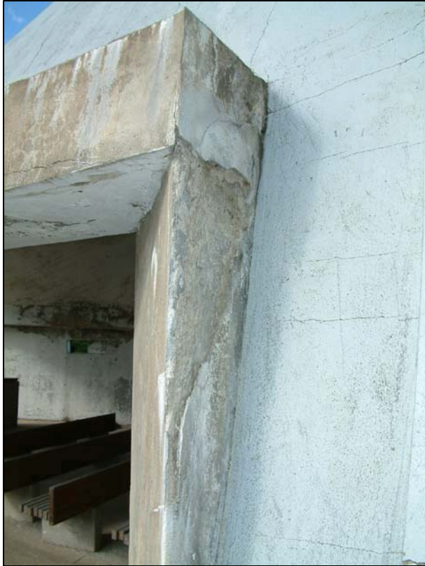
187. Surface délamérée sur une arête extérieure.
