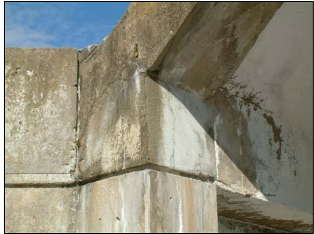
186. Traces de vieillissement du béton.
