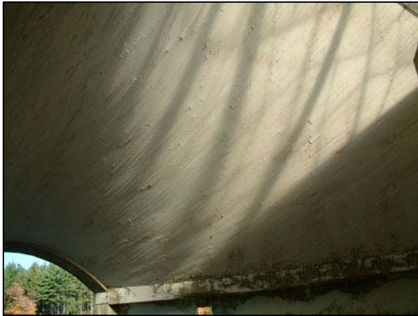
64. Paroi intérieure du voile mince en béton de la chapelle. L'éclairage met en relief les traces de décoffrage du béton.
