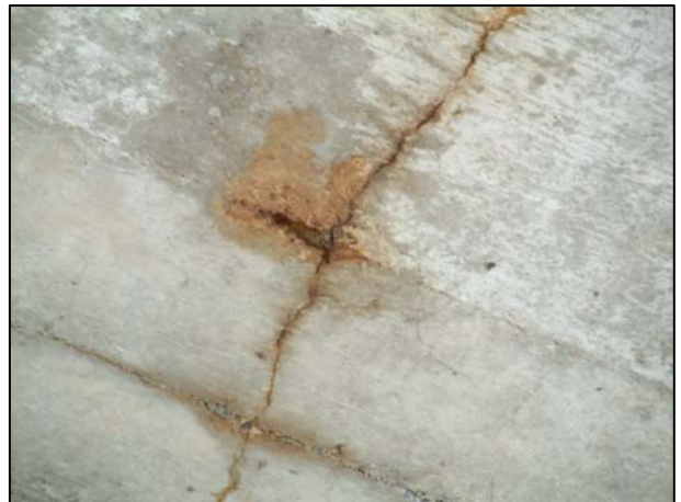
189. Armature rouillée visible au plafond de la partie centrale.
