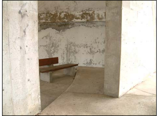
188. Peinture écaillée sur les parois intérieures.
