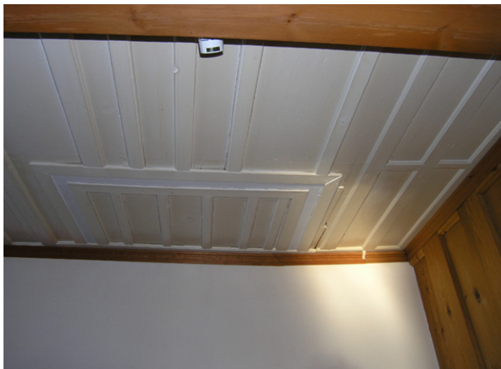
16. Trace de la cheminée dans le plafond à couvre-joints. Photo Camille Lapointe
