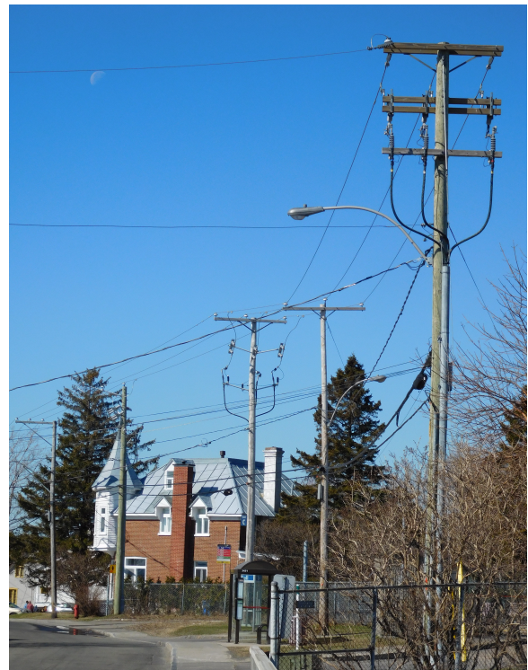
Les fils verticaux qui rejoignent les poteaux qui sont récents servent à alimenter des développements domiciliaires situés au sud de l'avenue Royale...
